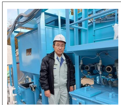
ダイオキシン排水処理装置
